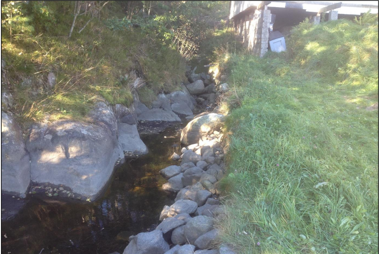
Figur 6.19. Vandringshinder 1 sees på siden av hytta i bildet. Hinderet kan trolig passeres ved flomvannføring. Sonen nedenfor hinderet er sterkt påvirket av sand og sedimenter som kommer fra sjøen, og trolig tidvis saltvannspåvirket. Foto: Rune Søyland
