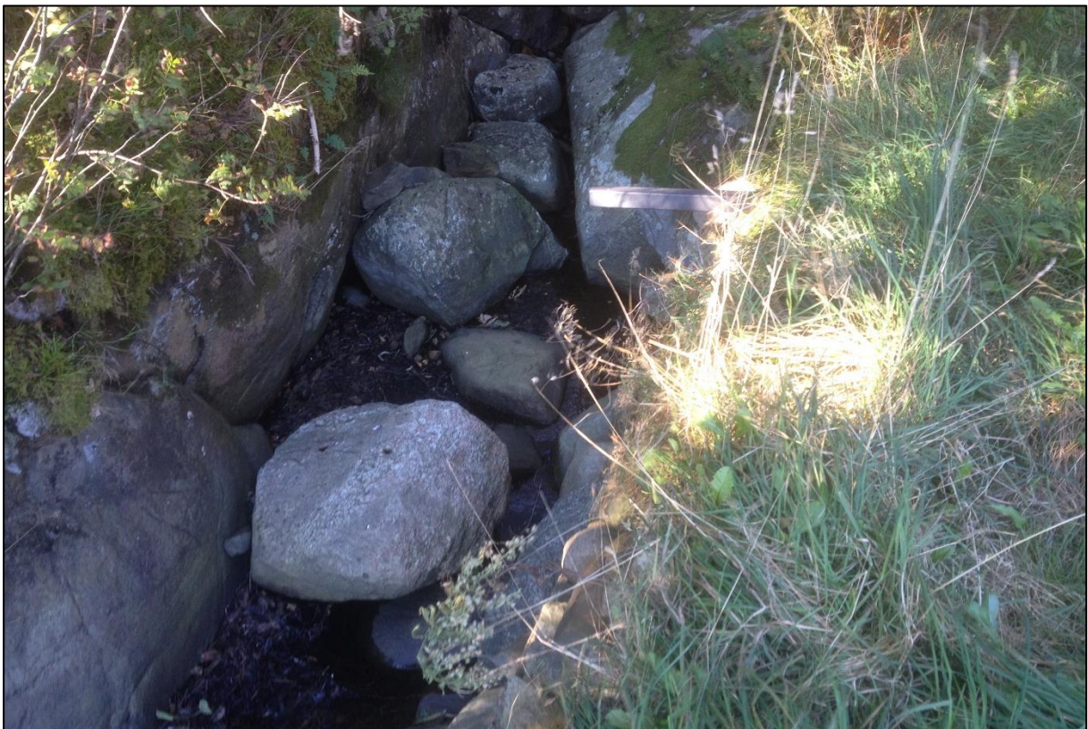
Figur 6.20. Vandringshinder ved hytte som kanskje kan passeres ved flomvannføring. Foto: Rune Søyland
